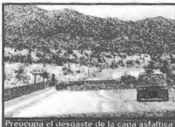
Preocupa el desgaste de la capa asfáltica
