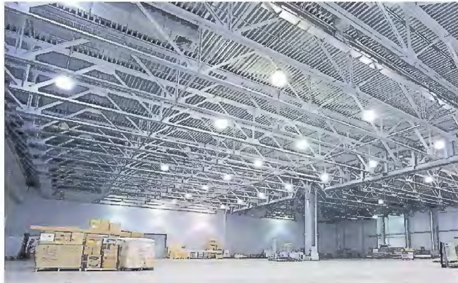
Luminarias LED en depósitos industriales
